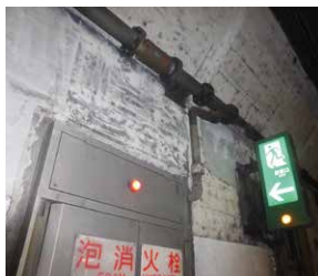
■ トンネル防災設備
