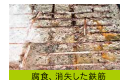
腐食、消失した鉄筋
